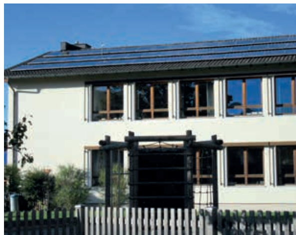
PV-Anlage am Dach der Grundschule
