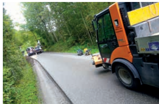
Bankette vor der Sanierung
